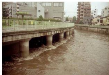
神田川取水施設取水状況
